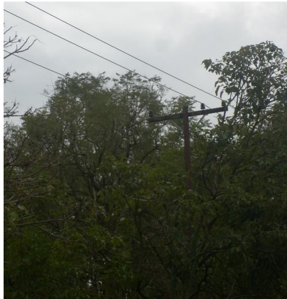
Figura 1.3: Línea aérea de conductores desnudos COV próximo a arboles
