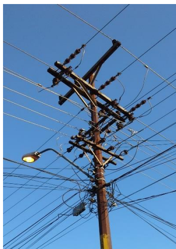
Figura1.2: Sistema de distribución aérea de conductores desnudos, ANDE
