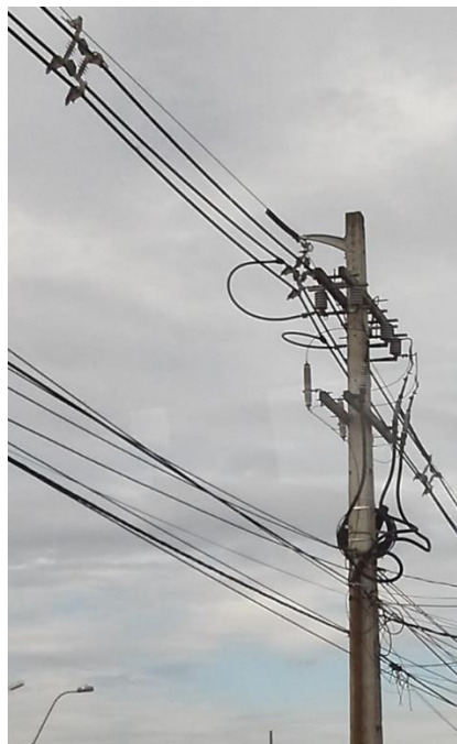
Figura 1.4: Línea aérea protegida en 23KV de la ANDE
